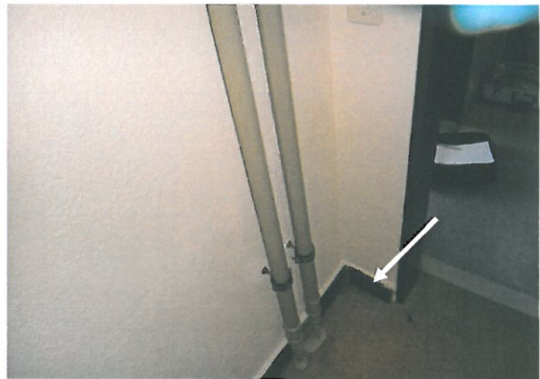
Abb. 4: Pavillon 1: WC, Kleber Sockelplatten, schwarz
