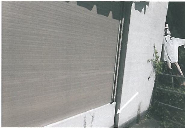
Abb. 31: Nebengebäude: OG, Terrasse, Fugendichtmasse
