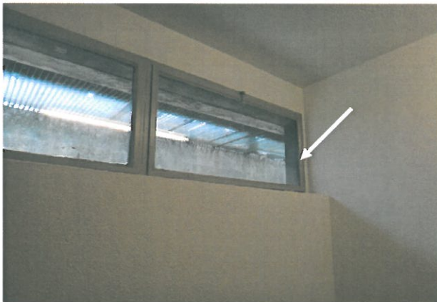
Abb. 39: Turnhalle: UG, Herrenkabine, Kitt im Glasan- schluss
