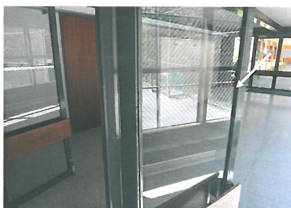
Abb. 36: Turnhalle: EG, Haupteingangstüre, Kitt im Glasanschluss
