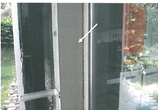
Abb.35: Nebengebäude: EG, Hintereingang, Kitt im Fensteranschluss
