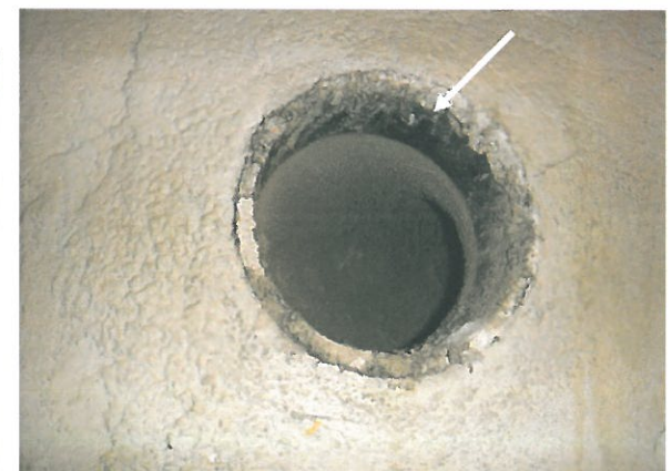
Abb. 24: Pavillon 1: UG, Diverse Futterrohre Lüftung
