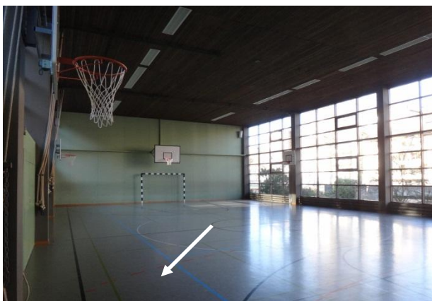
Abb. 5: Turnhalle, Messpunkt Raumlufmessung Chemie
