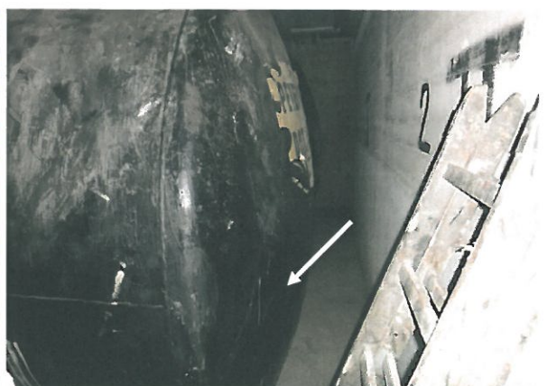
Abb. 30: Nebengebäude: UG, Öltank, Anstrich, schwarz
